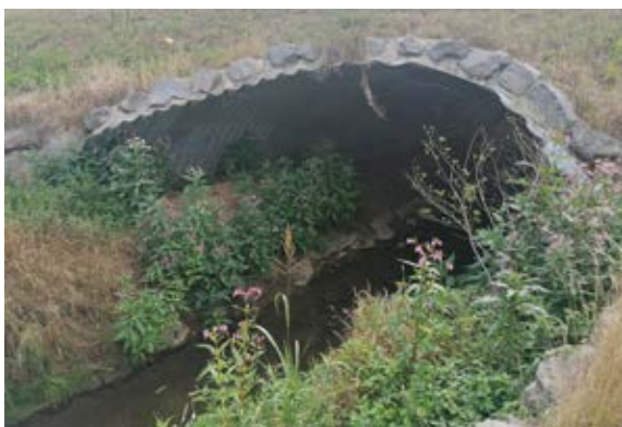
Starkes Neophytenaufkommen als Hemmschuh einer ansonsten gut umgesetzten Gewässerquerung
