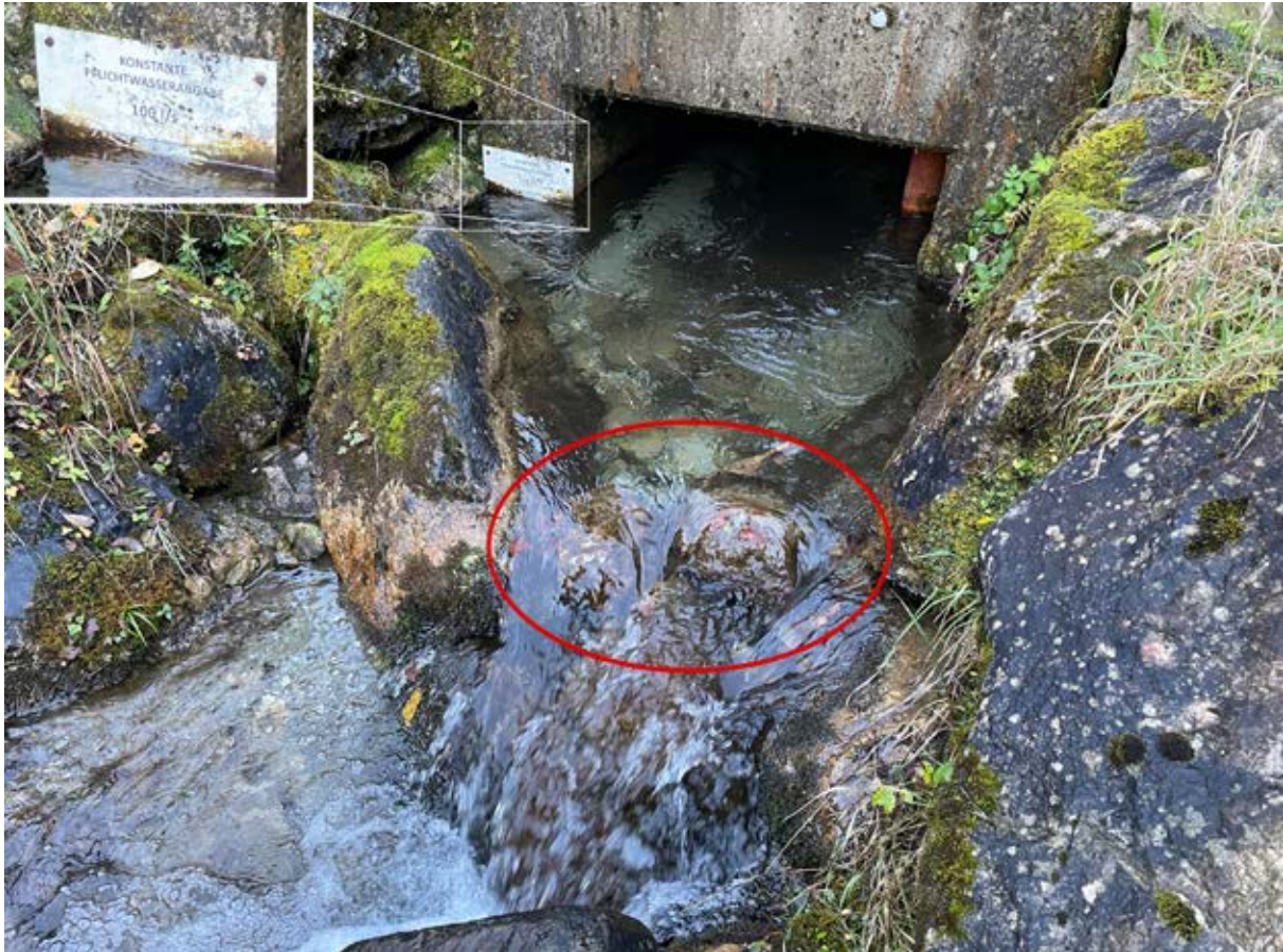
Nur 20 l/s anstatt der vorgeschriebenen 100 l/s abgegeben*
